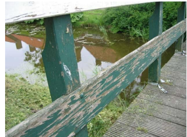
scenario 2: Vervangen houten onderdelen na einde levensduur en regelmatig conserveren
